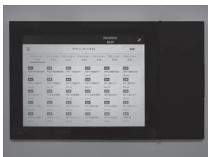
中央監視装置更新
